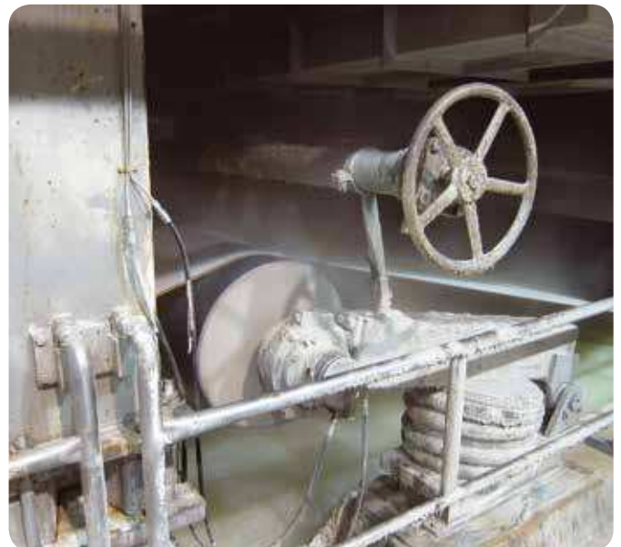
Fig. 7 – Environnement fortement humide d'un rouleau tendeur de toile d'une table de fabrication. La graisse présente au niveau du joint à chicane empêche l'eau de process de pénétrer dans le palier
