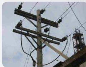
Falhas de linha de distribuição
