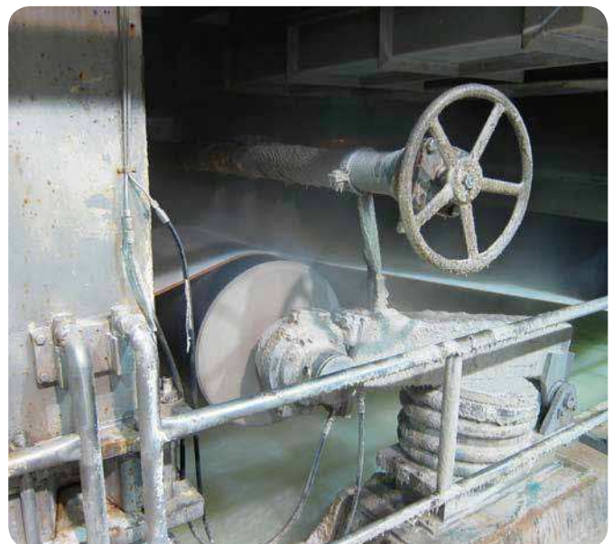
Fig. 7 O ambiente de alta umidade de um rolo de fio em um trecho da máquina de papel da seção de formação. Graxa na vedação do labirinto freia a entrada de água de processo no compartimento do rolamento.
