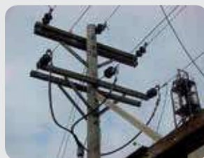
Chyba rozvodného vedení
