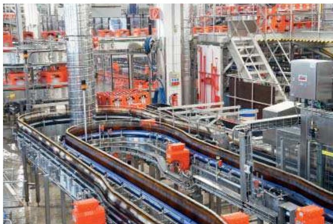
Die komplexe Abfüllanlage bei Erdinger Weißbräu erfordert eine Aufteilung des Schmierystems in einzelne Sektionen.
