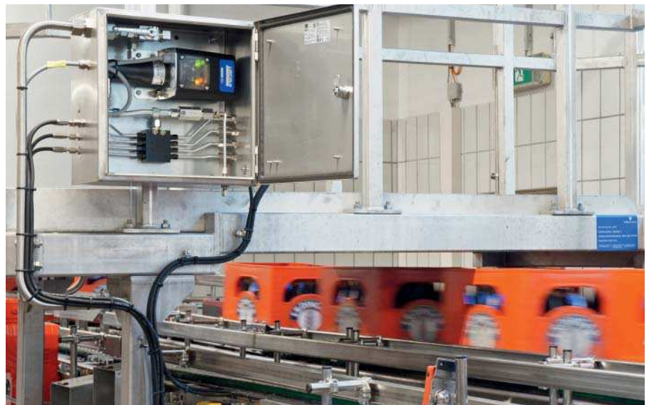
Blick in einen Sektionalschrank mit EDL1, Progressivverteiler und Absperrhahn zur Hauptleitung
