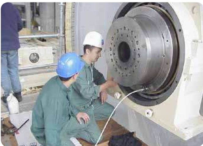
Fig. 8 Roulement à rouleaux toroïdaux CARB, monté selon la méthode de l'enfoncement axial SKF, sur un cylindre Yankee, en France, en 1999. Le technicien SKF contrôle le déplacement axial du roulement à l'aide du comparateur à cadran visible sur la fig. 9.
