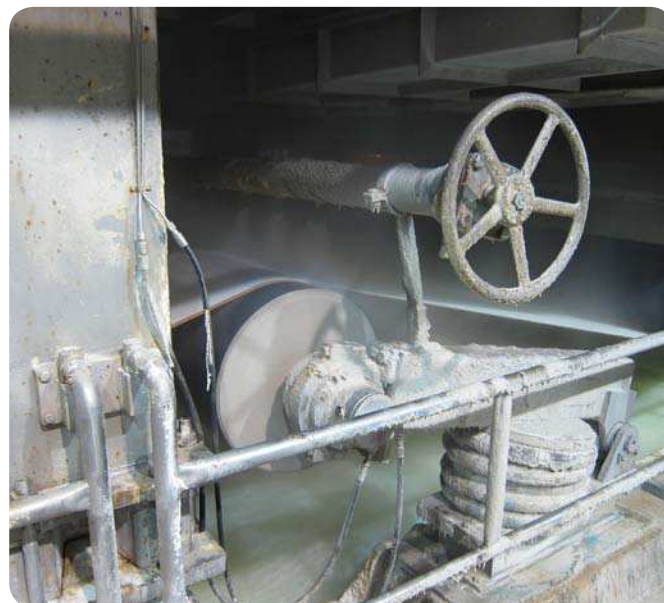
Fig. 7 Entorno de alta humedad de un rodillo tensor de la sección de conformación de una máquina papelera. La grasa en el sello laberíntico detiene el ingreso del agua del proceso al soporte del rodamiento.
